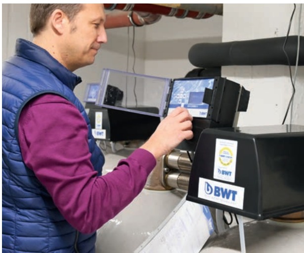
Patrick Brötzmann, Teamleiter Technik, überprüft die Einstellungen der Entkalkungsanlage
